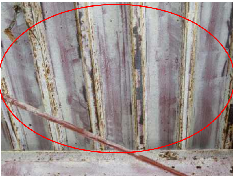
鉄骨デッキプレート部の 石綿含有吹付けひる石の 取り残し(剥離剤併用手工 具ケレン工法)
