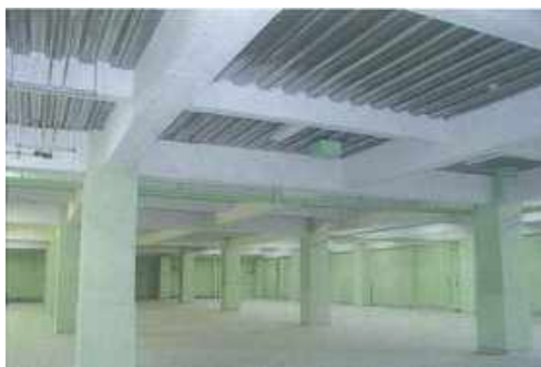
(参考資料) 写真 6-12 けい酸カルシウム板第 2 種を耐火被覆として使用している例 (この施工例は石綿含有なし製品)
