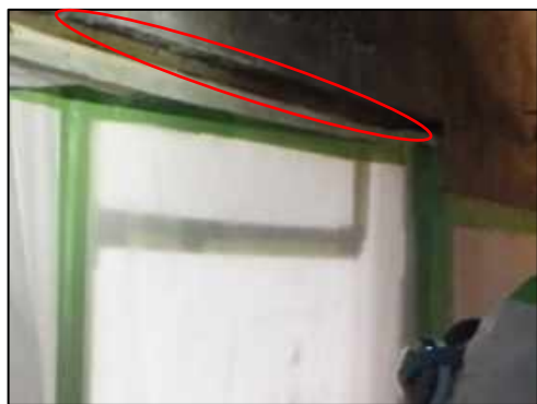
図4.15.6 コンクリート梁の下端に石綿が残っている例
