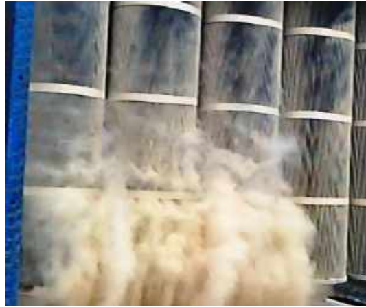
写真Ⅲ-3 フィルタ自動再生状況
