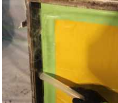
図 4.7.49 HEPA フィルタ 周辺部分
