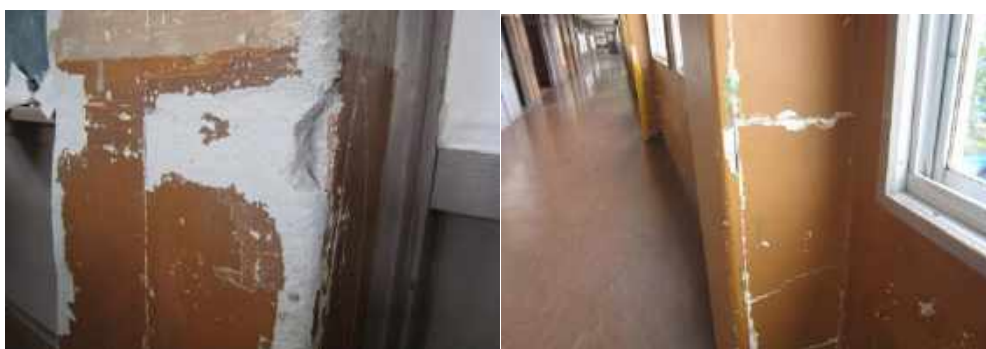
(参考資料) 写真 6-13 鉄骨造校舎 教室・廊下の柱 長年の接触により欠損している
