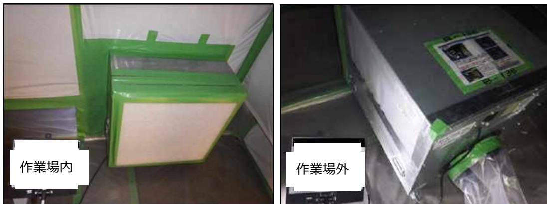
図 4.7.37 集じん・排気装置を負圧隔離養生の壁ライン上に設置した例
