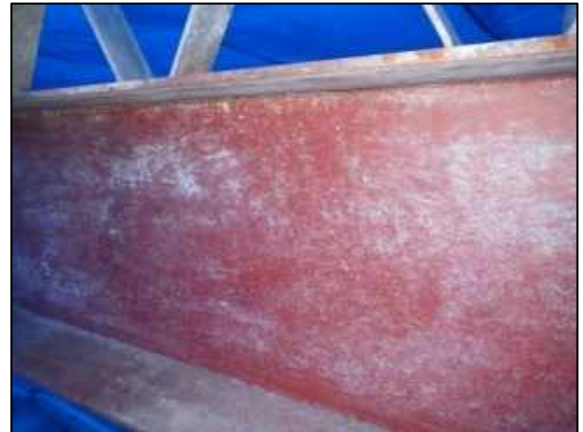
図 4.7.70 再付着した石綿の例
