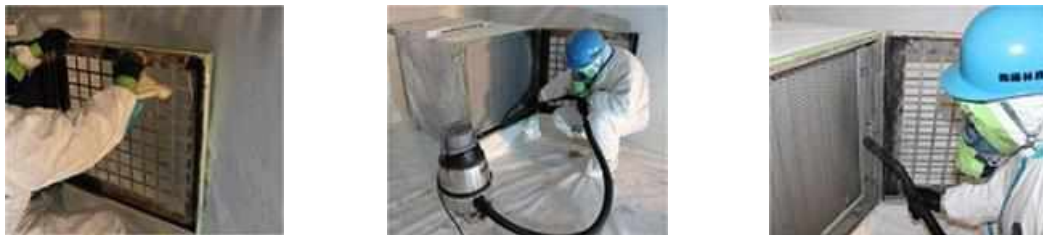
図 4.7.83 HEPAフィルタ等の清掃
