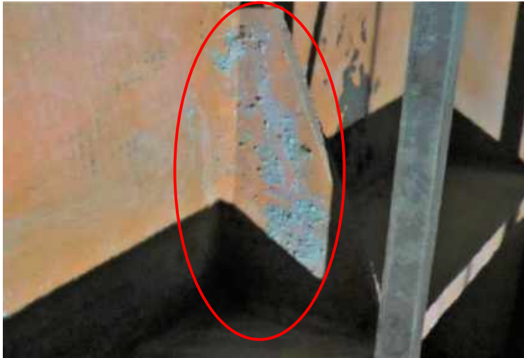
鉄骨梁側面の取り残し
