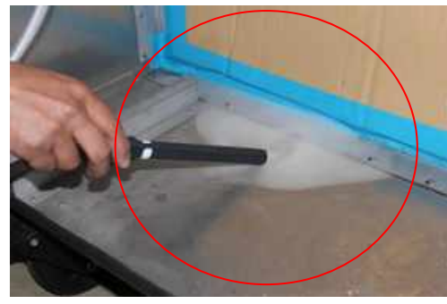
HEPA フィルタ取り付け面の隙間から 煙が吸い込まれていく
