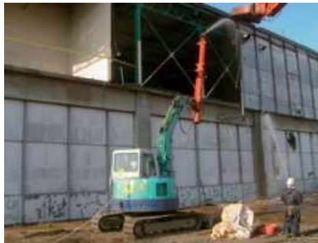
図4.11.5 湿潤化の例 (作業内容に応じて立入禁止措置や掲示を行うこと)
