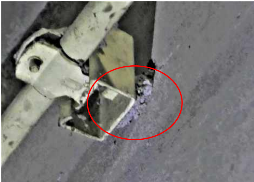
電線管ダクター部の清掃不良
