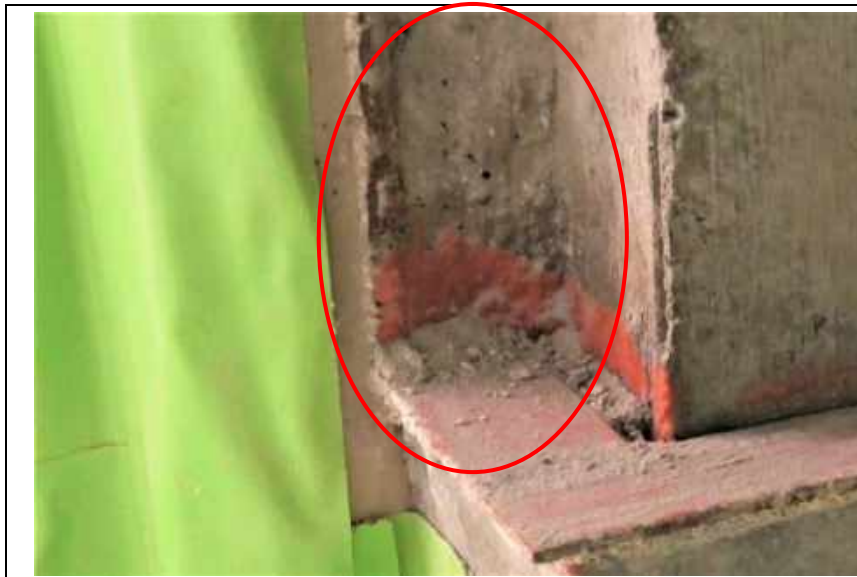
腰壁入隅部の清掃不良
