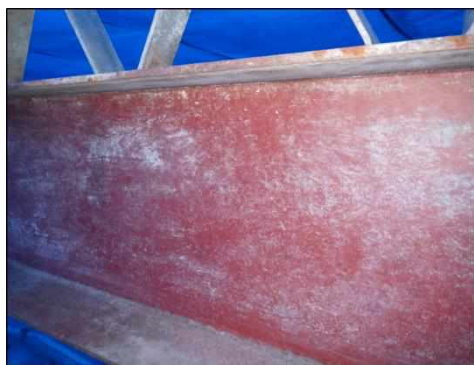
図4.15.4 除去面に再付着し残っている石綿の例
